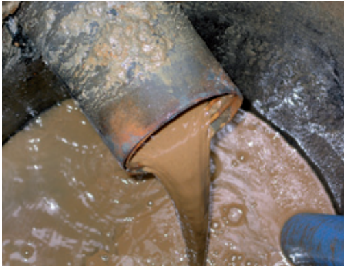
Salaojakaivo, jossa runsas rautasaostuma.
